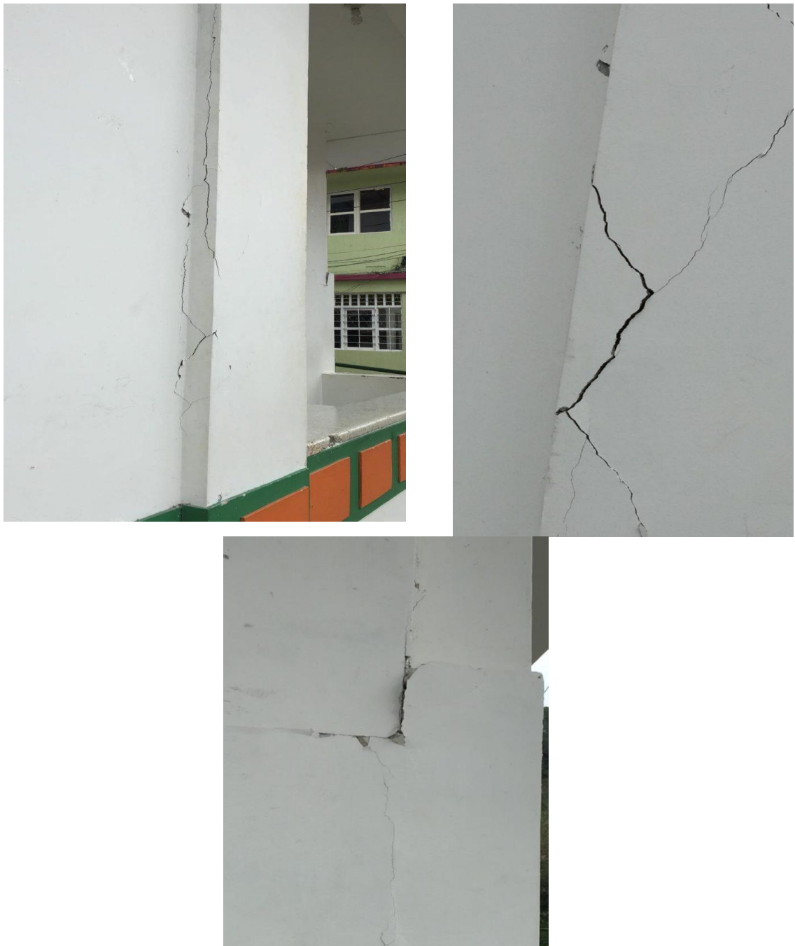
Figura 5. Afectaciones en la alcaldía de Argelia, Valle del Cauca.
