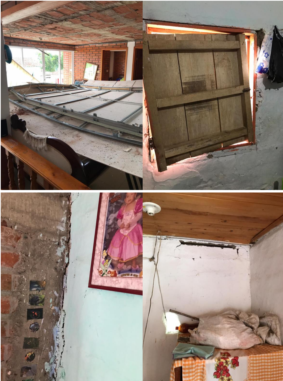
Figura 4. Afectaciones en el municipio de Versalles, Valle del Cauca. Fuente: Gestión del Riesgo del municipio de Versalles.
