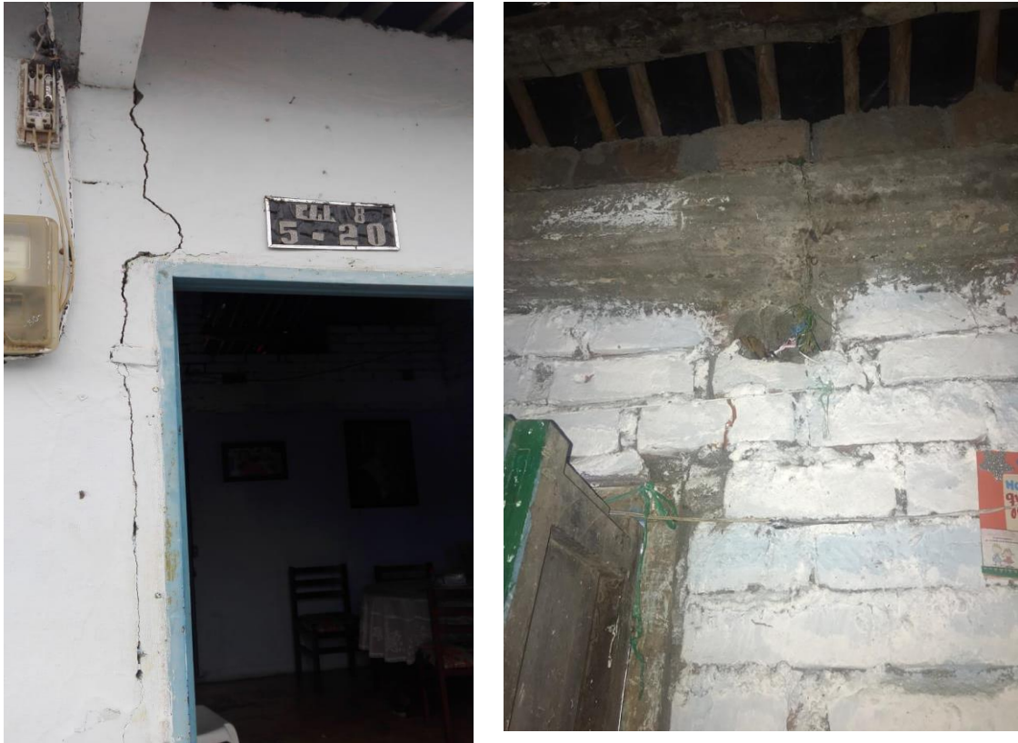
Figura 2. Grietas en viviendas del barrio Palermo en el municipio de Toro, Valle del Cauca.
