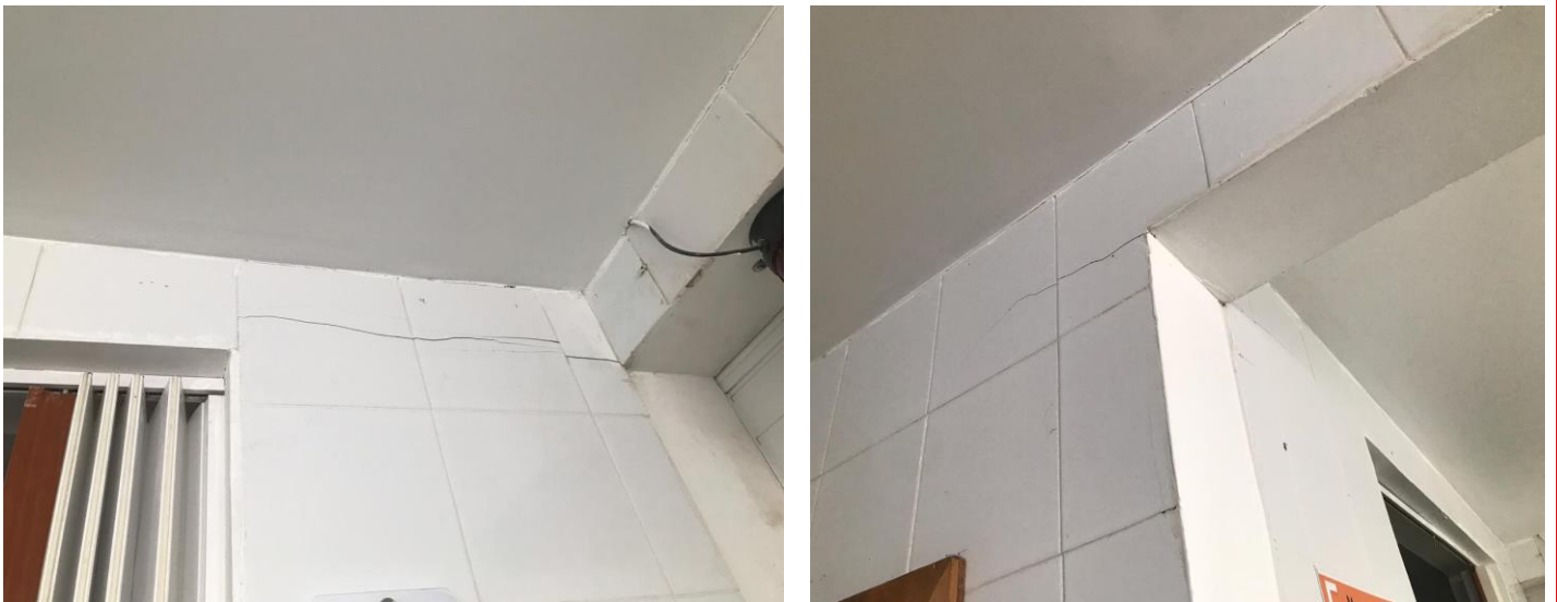
Figura 3. Grietas en el revestimiento del Hospital Sagrada Familia.
