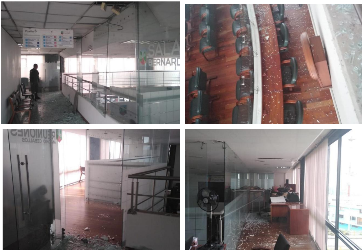
Figura 6. Daños en el Concejo de Manizales, Caldas.
